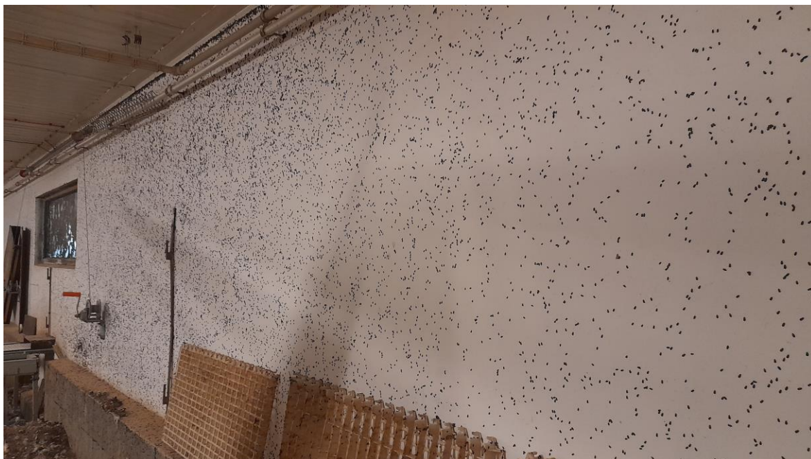
Obrázek 7: Masivní invaze potemníka stájového na stěnách stáje po ukončení turnusu (foto: V. Sládeček).
